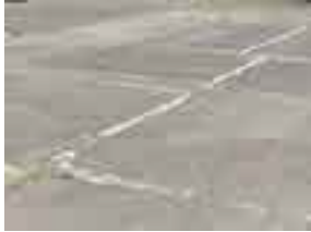
舗装されたアスファルト ひび割れて元の土が現れ、植物が顔をだす
