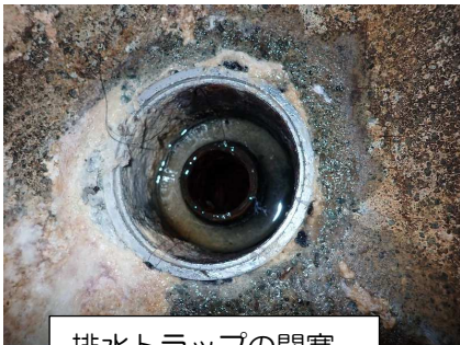
排水トラップの閉塞
