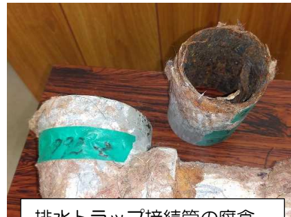
排水トラップ接続管の腐食
