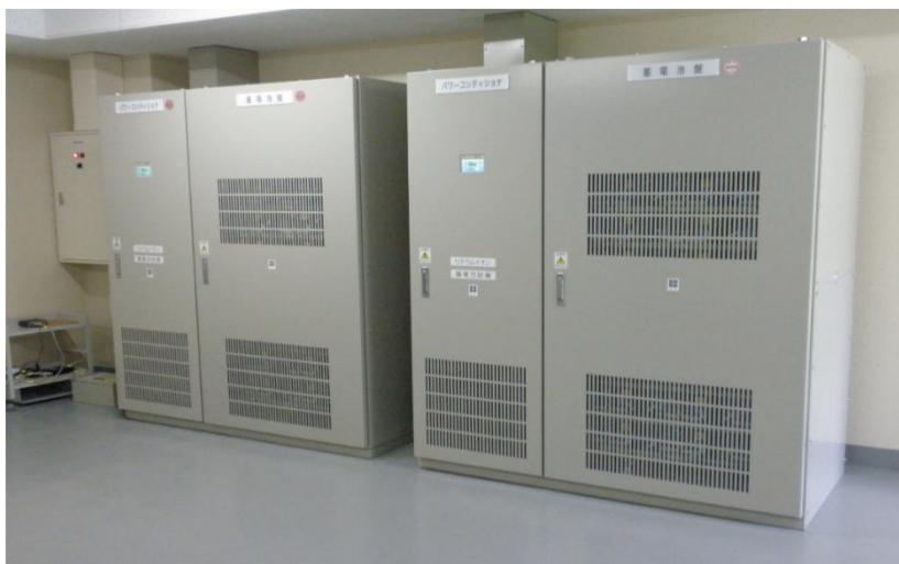
蓄電システム
