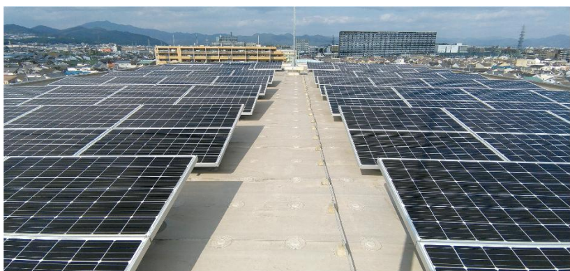
太陽光発電設備 40kW
