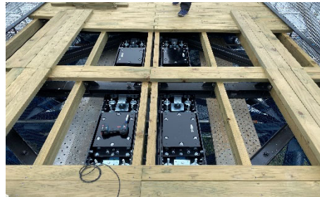
TMD 設置事例
