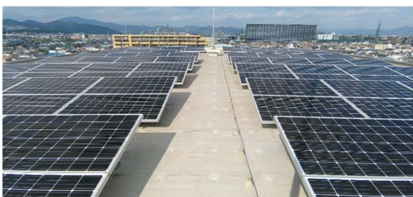
太陽光発電設備 40kW
