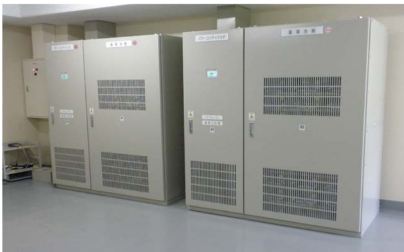
蓄電システム
