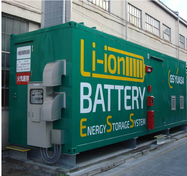
電力貯蔵システム
