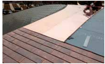
防水用巻きハゼ大板施工中の様子。この上に吊子をハンダ付け平葺き
