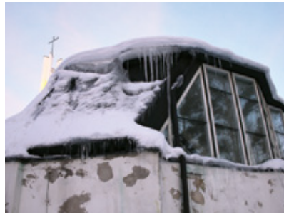
外壁の損傷がはっきりわかる (撮影: Niina Svartström)
