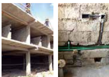
石積壁に埋め込まれる設備配管
