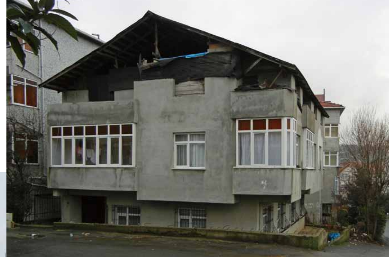
(上) 組石造の 1 階に積み重ねられた木造の 2・3 階 (下) 1 階平面に全く関係無く建築された 2 階。3 階は工事中で止まったままとっている。
