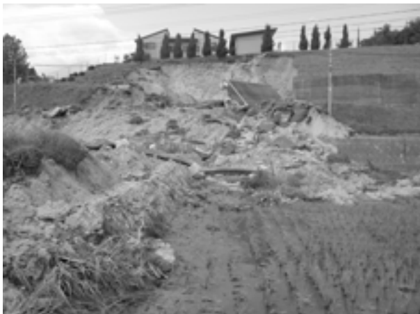
鷺沢工業高校南斜面の崩落現場
