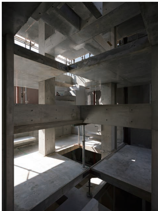
上棟時の躯体の姿。床と梁が分離しながら積層する (撮影: Takeshi YAMAGISHI)
