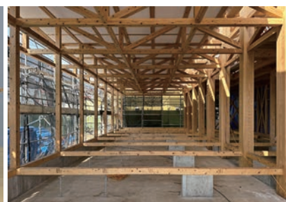
進行中の「戸塚のオフィス」。300角の柱で水平力に対応する架構
