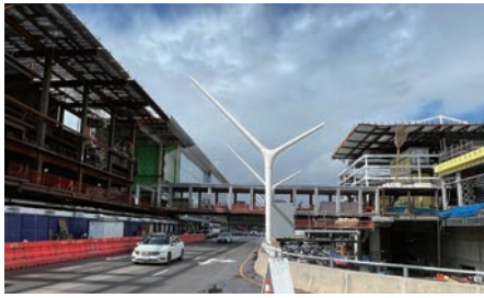
ロサンゼルス国際空港、左の国際ターミナルとブリッジで繋がる新設駅が右手
