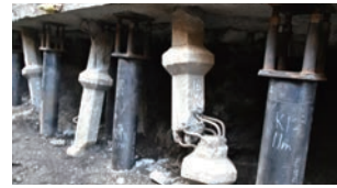
熊本地震で被災した公営住宅の杭基礎 復旧工事を視察
