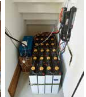
蓄電池(コントローラー、インバータ)
