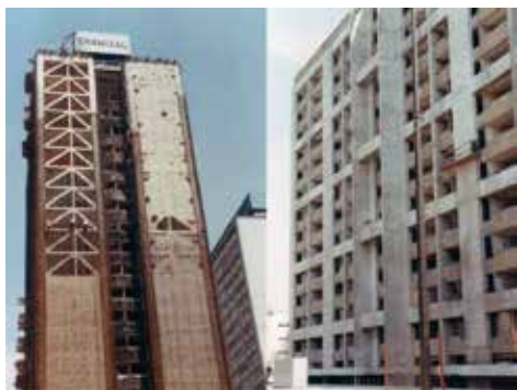
写真1 1985年の被害。 高層共同住宅トラテロルコ団地。耐震壁とメガフレームによる補修補強 (1987年撮影)
