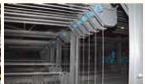
吊物機構のメンテナンススペース
